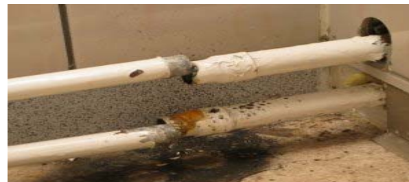
Frostschäden an CU-Rohr Bilder: IFS Kiel
